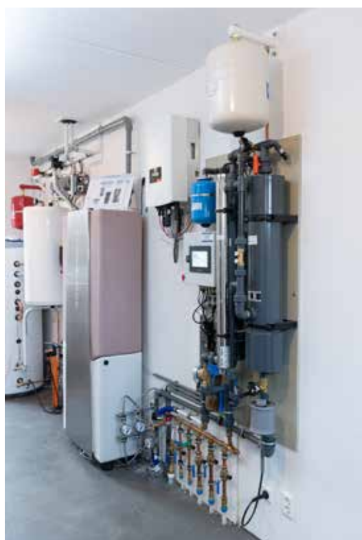
Het SafeWater-systeem rechts en de Hydraloop links in de technische ruimte waar het waterzuiveringssysteem en de distributie zijn ondergebracht.
